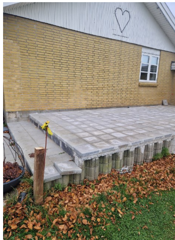
På tænkt placering af turbine (stolpe m. markeringsbånd)
