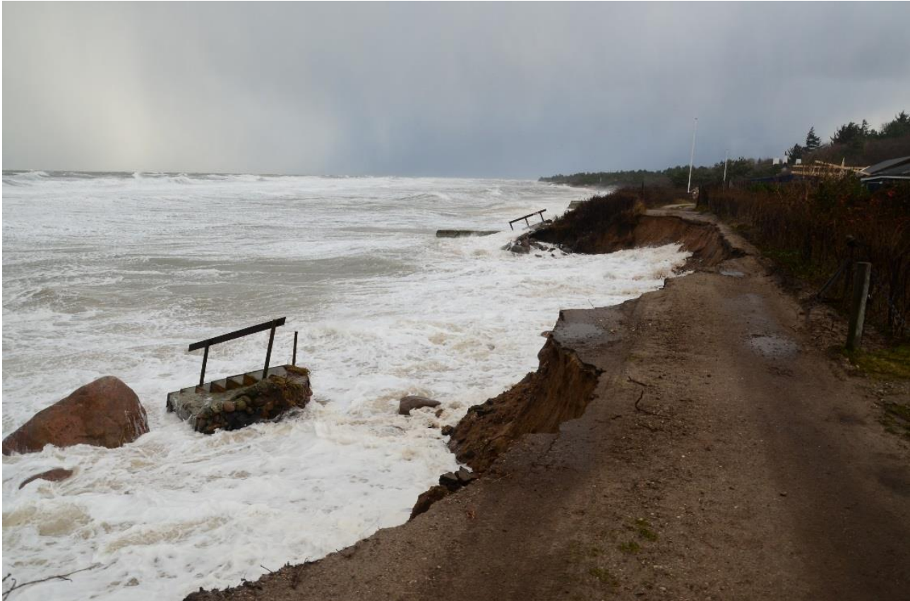
Figur 3.3 Akut erosion af skrånningen ved Havstokken, Udsholt, Gribskov Kommune, under stormen Bodil 06.12.2013, Kilde: (COWI, 2016)
