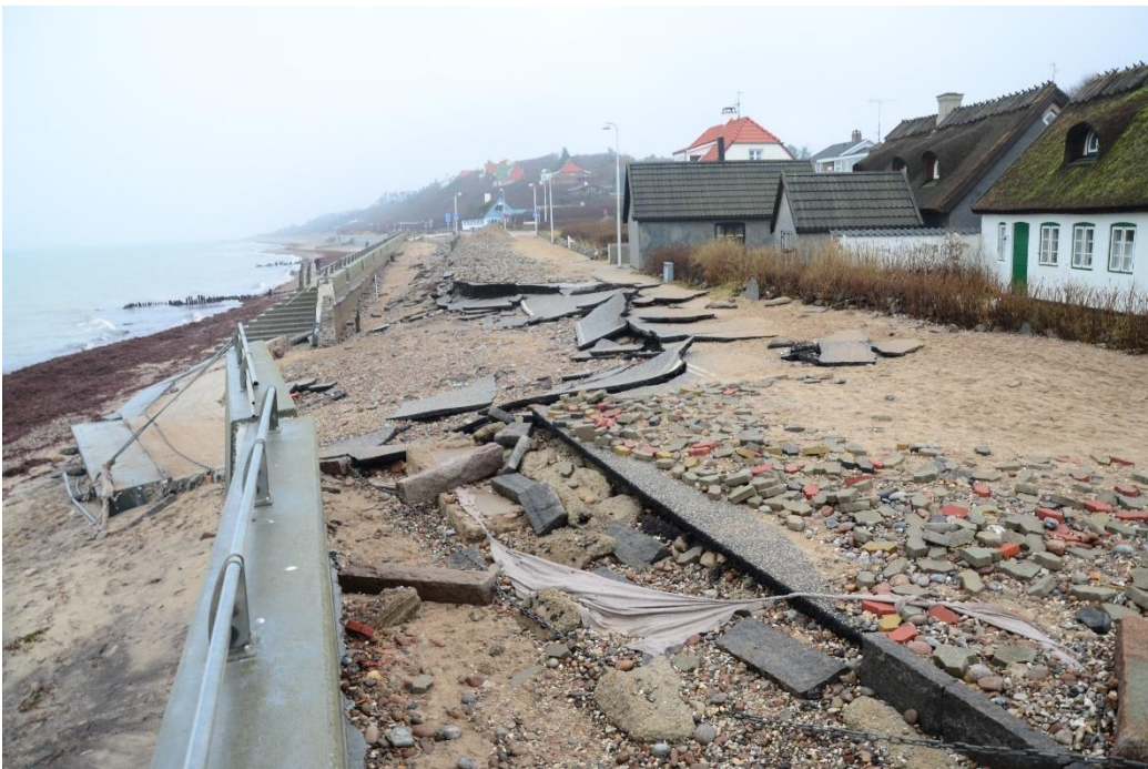
Figur 12: Skader på kystvejen i Rågeleje under og efter stormen Bodil den 6. december 2013. Foto: Christian Helledie
