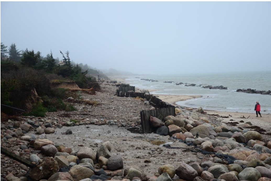
Figur 14: Erosion af skrånningen i Smidstrup under og efter stormen Bodil den 6. december 2013. Foto: Christian Helledie
