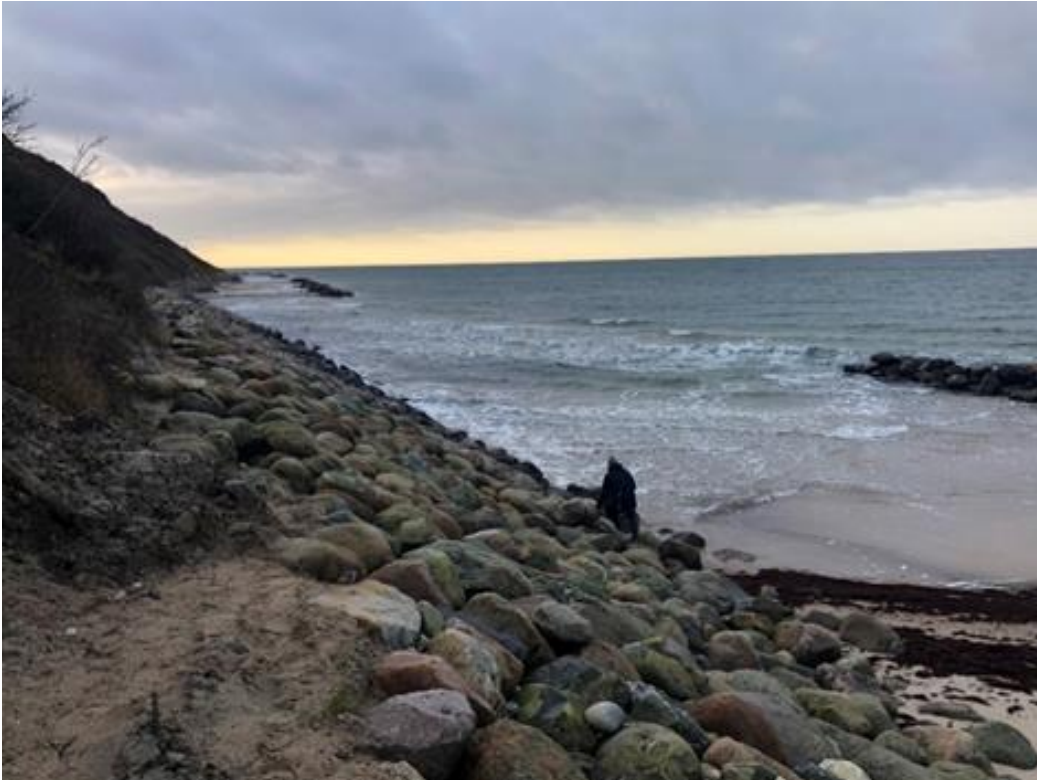
Figur 16: Stranden er forsvundet foran skråningsbeskyttelsen ved Vejby. Foto: Christian Helledie
